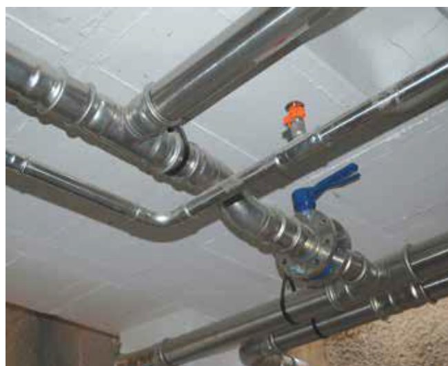
Figura 20a - inoxPRES - Impianto spinkler in magazzino
