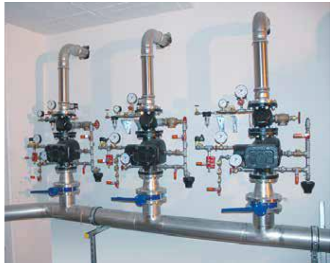
Figura 17 - inoxPRES - Installazione antincendio
