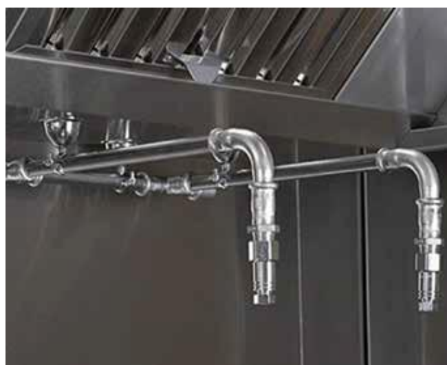
Figura 20b - inoxPRES - Impianto spinkler in cucina industriale
